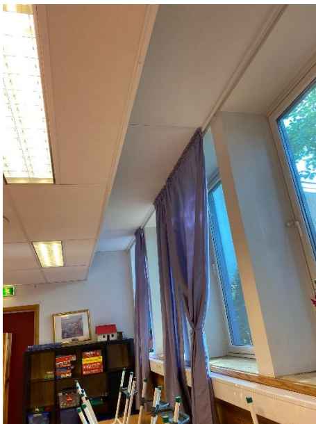
Lyssjakt i tak, gardiner.
